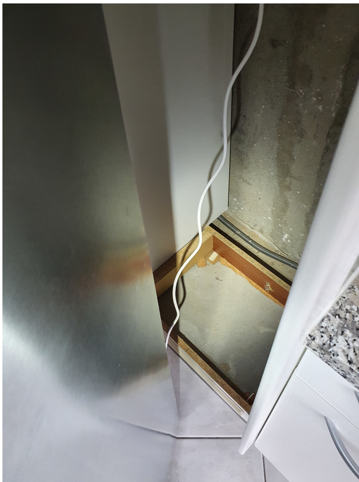
Abbildung 1: Der ausgebaute Kühlschrank und der Hohlraum dahinter.
