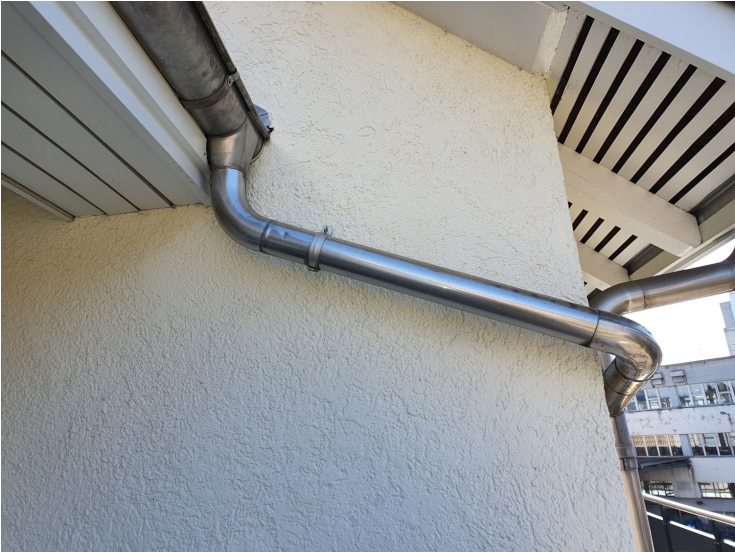
Abbildung 2: Dachrinne und Abwasserrohr als Versteck
