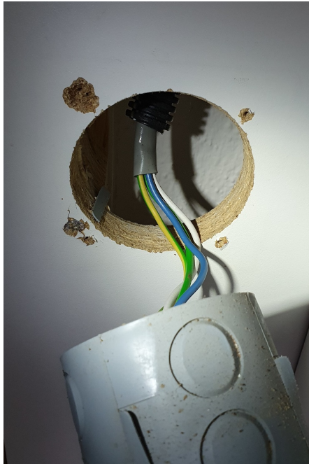
Abbildung 3: Manchmal kriegt man über eine ausgebaute Steckdose auch Zugang zu einem versteckten Totvolumen in der Wand.
