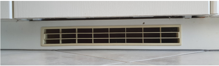
Abbildung 3: Lüftungsgitter unter dem Kühlschrank
